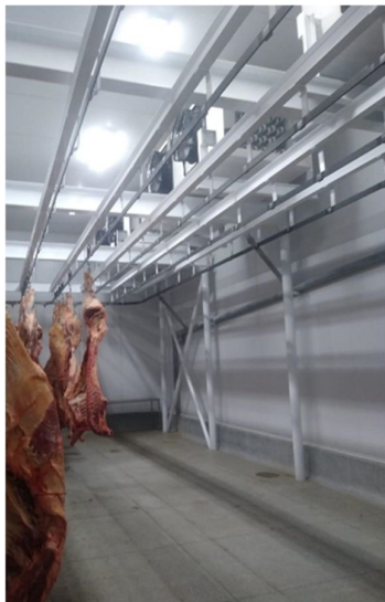
Figura 2 - Evaporadores de ar forçado da câmara de resfriamento. Fonte: Os autores (2020).
