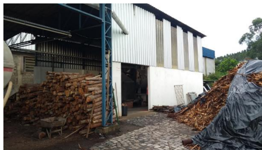
Figura 4 - Casa da caldeira da empresa X
