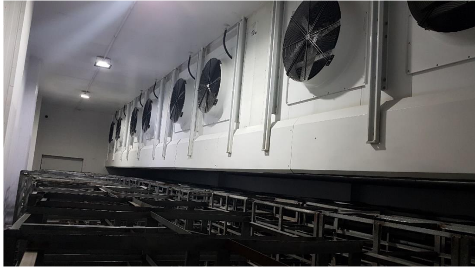
Figura 1 - Resfriadores de ar no interior do túnel de congelamento de aves.
