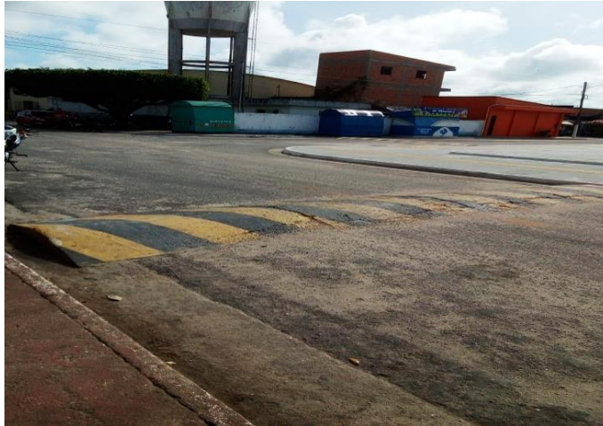
Figura 6 – Lombada com sinais de desgaste.
