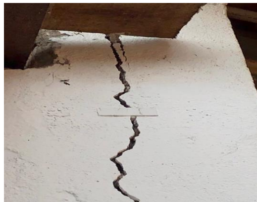
Figura 5 – Fissura vertical entre pilar e alvenaria.
