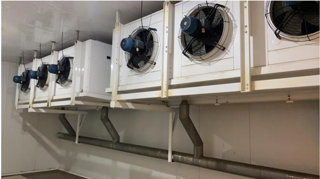
Figura 1 - Evaporadores de convecção forçada do túnel de congelamento.
