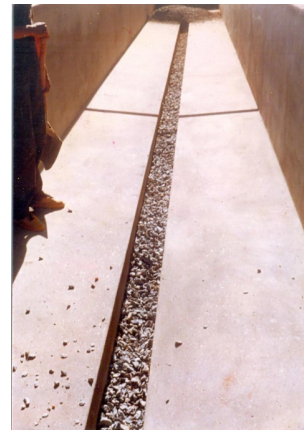
Figura 3. Fundo da caixa de solo. Construção em alvenaria, com drenagem de brita, captação central e desague em área externa à caixa de solo.
