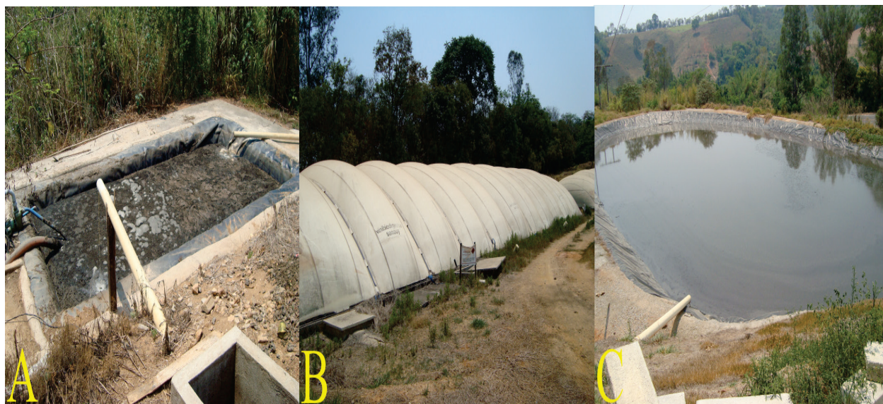
Figura 1. Sistema de tratamento de resíduos da suinocultura: A = tanque de equalização; B = biodigestores modelo canadense; C = lagoa de estabilização.
